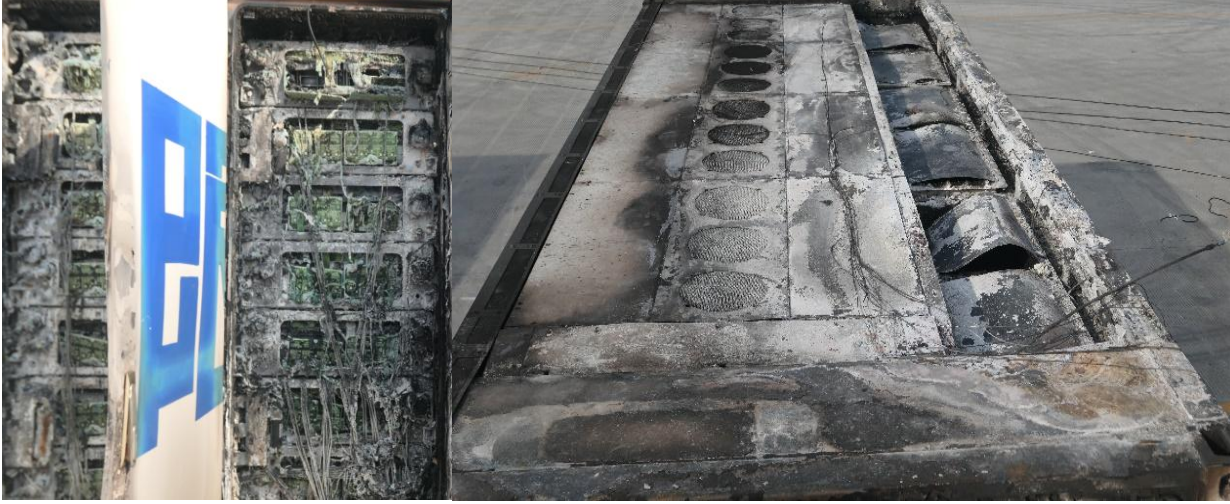
Konteyner A'nın yanma sonrası iç ve üstten görünümü
