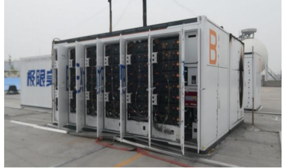
Konteyner B'nin yanma sonrası görünümü ve voltaj kontrolü
