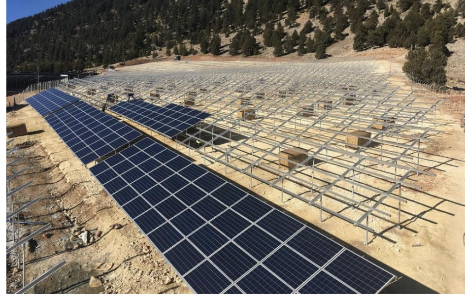
arazi tipi güneş enerjisi santrali
